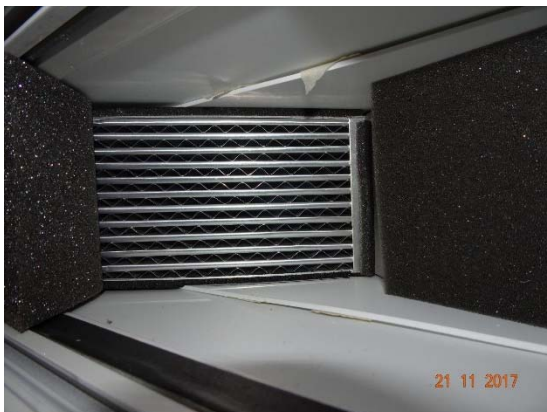
Abbildung 25: WNG ID 110: Wärmetauscher
