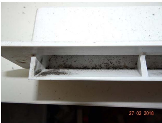
Abbildung 156: WNG ID 720: Ablagerung an ZUL-EI.
