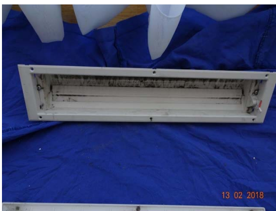
Abbildung 116: WNG ID 520: Ablagerungen AUL-EI.
