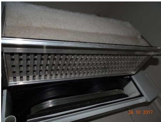
Abbildung 67: WNG ID 310: Wärmetauscher
