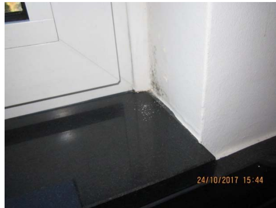
Abbildung 79: WNG ID 320: ev. Schimmelablagerung
