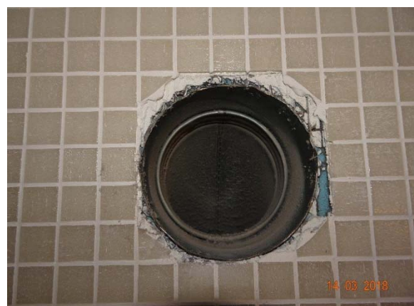
Abbildung 188: WNG ID 810: ABL-Rohr, Bad
