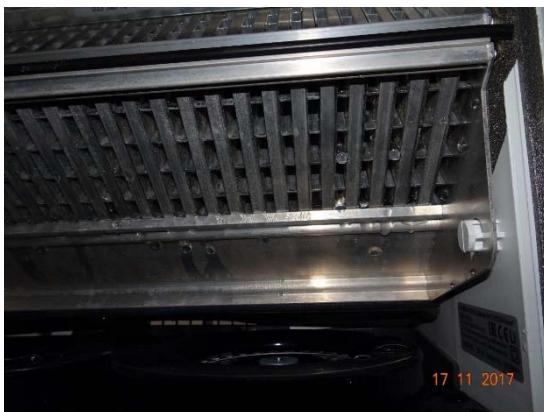
Abbildung 45: WNG ID 210: Wärmetauscher
