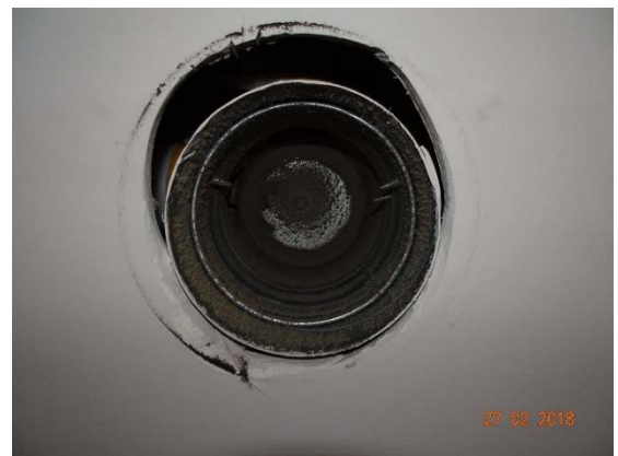
Abbildung 150: WNG ID 710: ABL-Rohr, Bad
