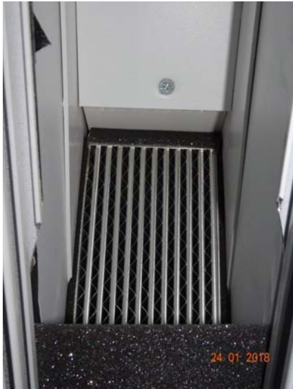
Abbildung 140: WNG ID 620: Wärmetauscher
