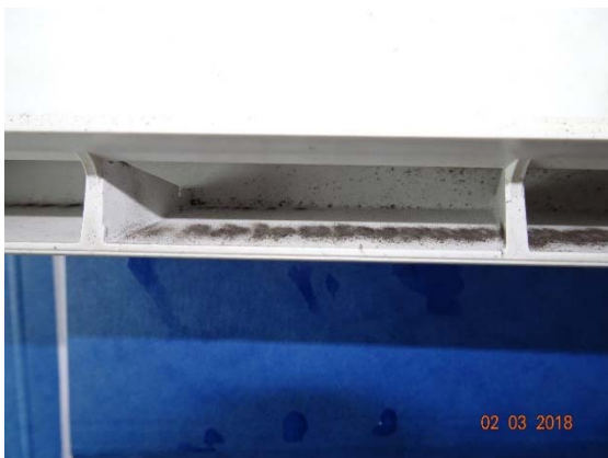
Abbildung 167: WNG ID 730: Ablagerung an ZUL-EI.
