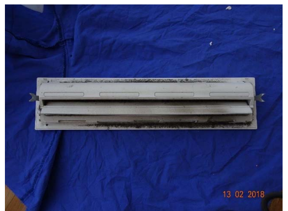
Abbildung 117: WNG ID 520: Ablagerungen AUL-EI.
