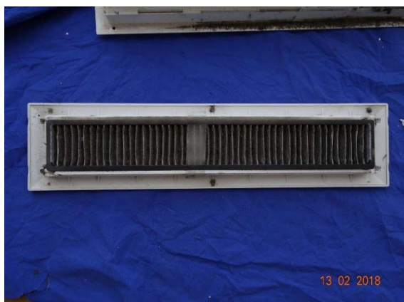
Abbildung 118: WNG ID 520: AUL-Filter, eingebaut
