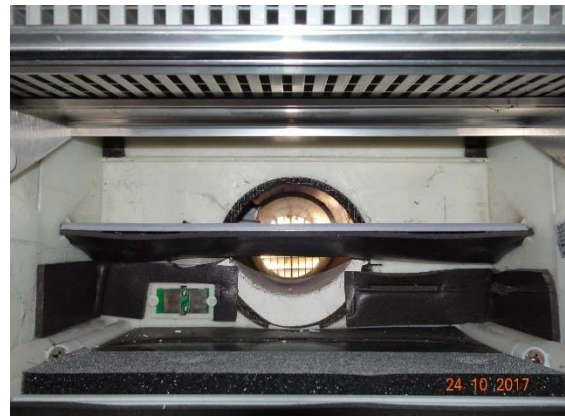
Abbildung 68: WNG ID 310: Lufteintritt in Gerät
