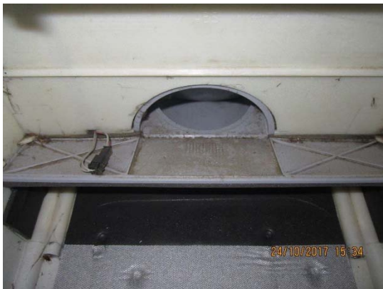
Abbildung 74: WNG ID 320: Lufteintritt in Gerät
