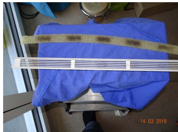
Abbildung 186: WNG ID 810: Zuluftfilter, Rückseite
