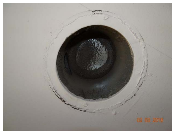
Abbildung 179: WNG ID 730: ABL-Rohr, Bad
