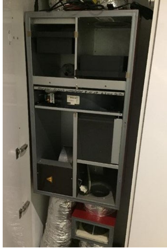
Abbildung 87: WNG ID 610: Lüftungsgerät
