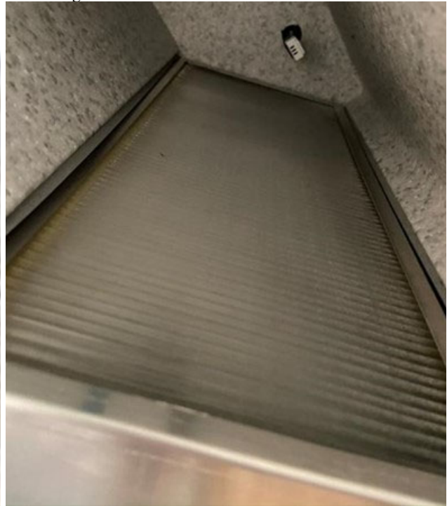
Abbildung 137: WNG ID 1110: Wärmetauscher
