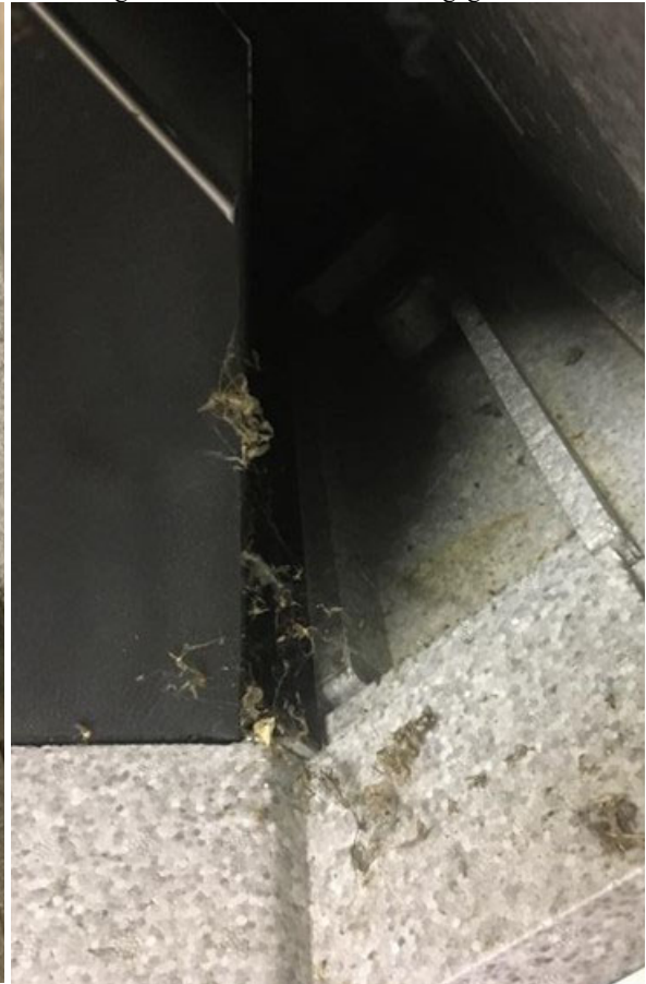
Abbildung 128: WNG ID 1010: Lüftungsgerät
