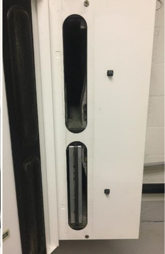
Abbildung 124: WNG ID 1010: Das Gerät wurde nur mit einem Aussenluftfilter betrieben
