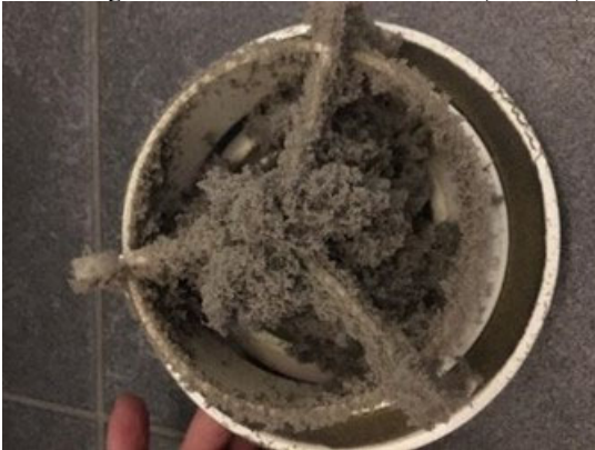
Abbildung 49: WNG ID 310: ABL-Ventil (Dusche)
