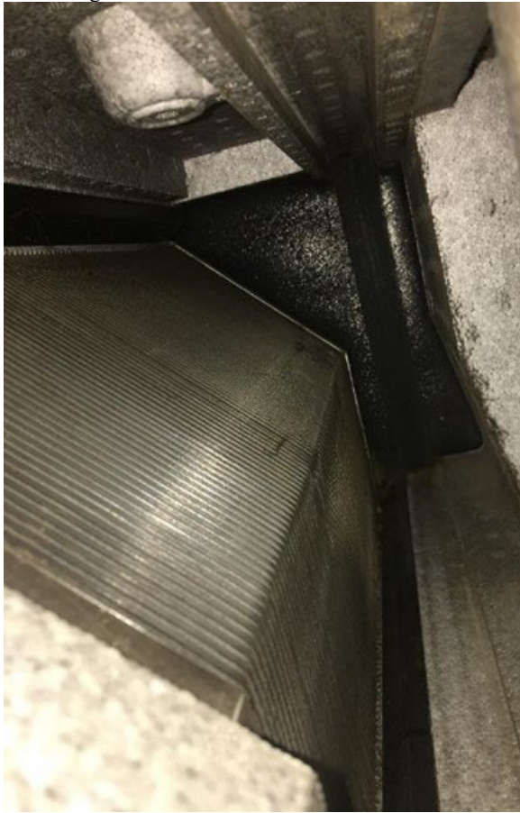
Abbildung 127: WNG ID 1010: Wärmetauscher
