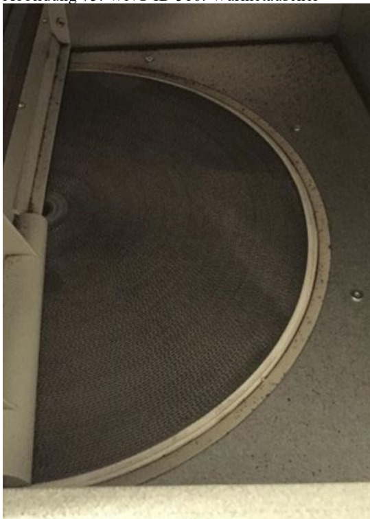
Abbildung 75: WNG ID 510: Wärmetauscher
