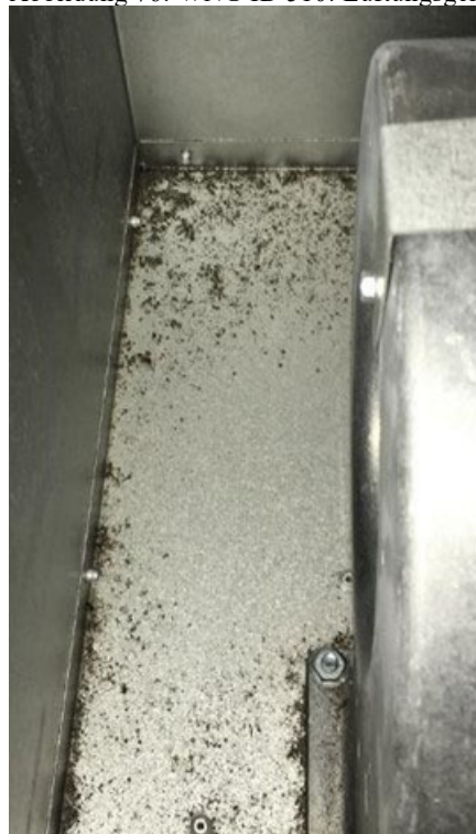
Abbildung 76: WNG ID 510: Lüftungsgerät
