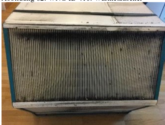
Abbildung 62: WNG ID 410: Wärmetauscher
