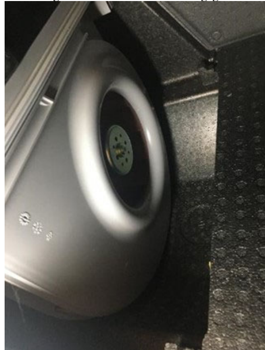
Abbildung 105: WNG ID 810: Lüftungsgerät
